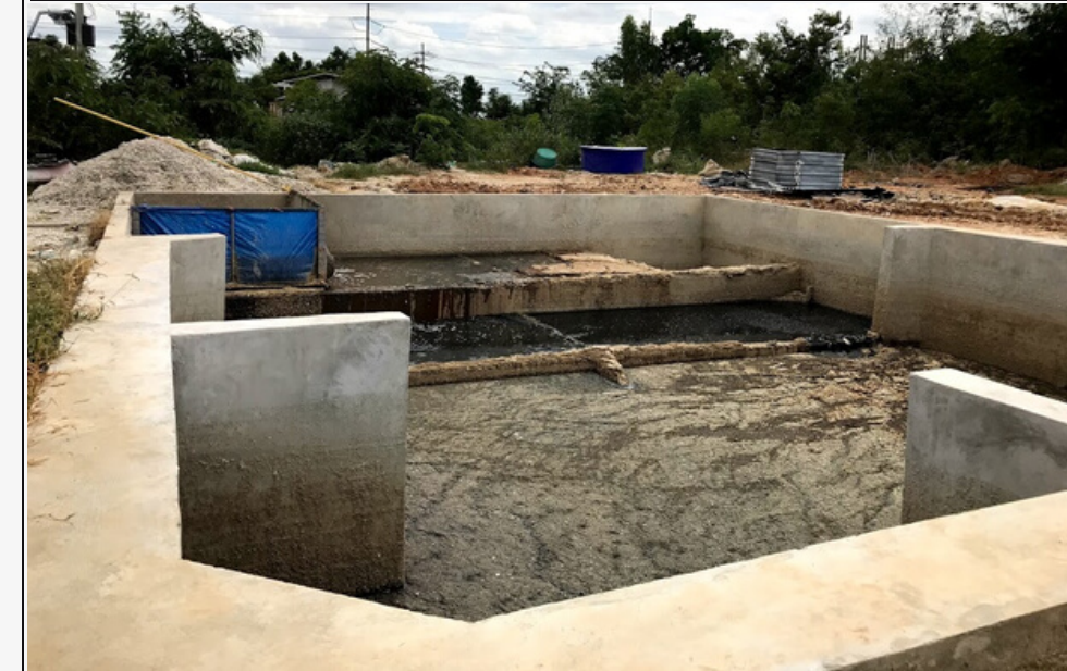
บ่อคอนกรีตกักน้ำเสีย
